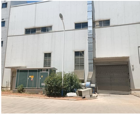
废气处理设施
