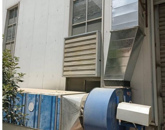
废气处理设施
